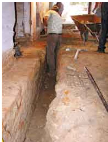
ODŚLONIĘTY FUNDAMENT KOSTNICY
