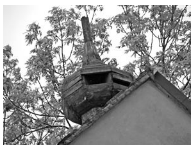
Zniszczona kopuła na wieży dzwonnicy – maj 2009 r.
