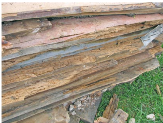
Spróchniałe deski z dachu dzwonnicy
